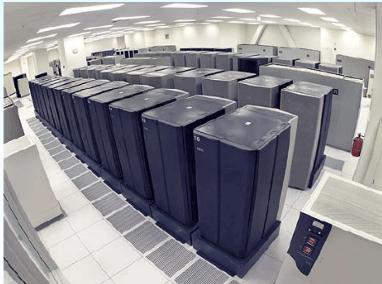
1 MW Data Center
