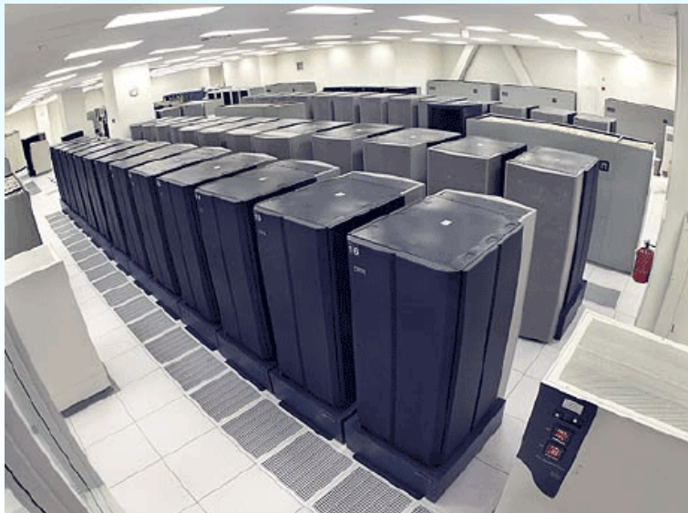
1 MW Data Center
